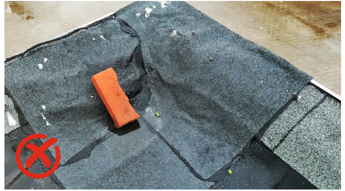
Als de hoek lekt is dit niet de manier van repareren.
