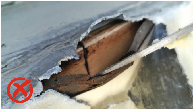
Nieuwe dakbedekking niet waterdicht aansluiten onder het bestaande versleten lood leidt tot lekkage.
