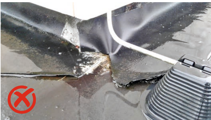
Aansluiting van een EPDM strook bij een buitenhoek moet volgens de verwerkingsrichtlijnen van de fabrikant te worden uitgevoerd en niet met een eigen inzicht een bitumen oplossing.
