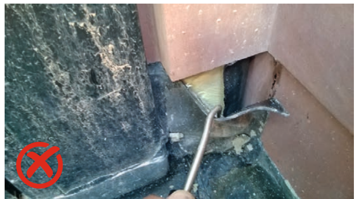
Aansluiten van een afwerkstrook bij opgaand werk hoort wel op de juiste wijze verkleefd te zijn.
