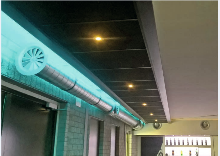
De zaal met ventilatievoorzieningen. Aan de ene zijde wordt lucht afgezogen, aan de andere zijde toegevoerd.
