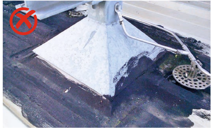
Het inwerken van doorvoeren op een staaldak blijft lastig.
