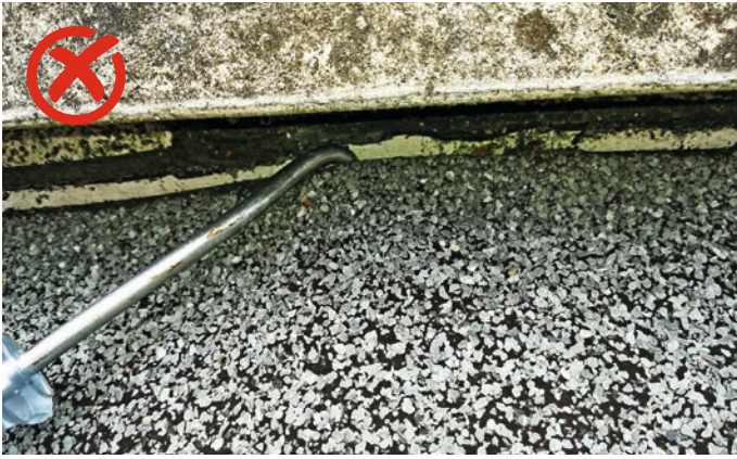
Aansluiten onder betonnen afdekkers: het blijft moeilijk.
