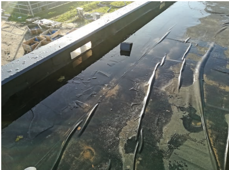
Ploovorming: niet mooi, maar technisch gezien niet erg, zo lang het de waterhuishouding niet beïnvloedt.
