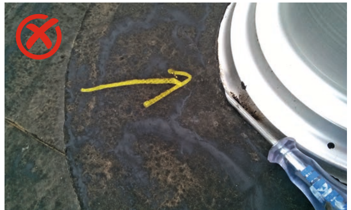
Ook bij een aansluiting tussen EPDM met een SBS kleeflaag is waterdichtheid nogal eens lastig.
