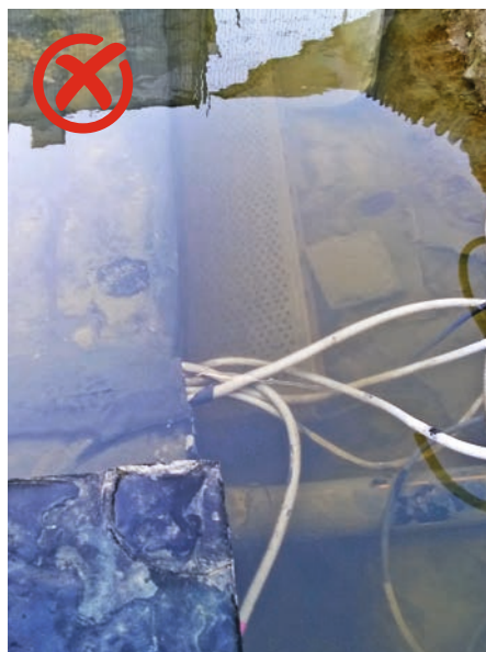
Kabeldoorvoeringen zijn moeilijk waterdicht te krijgen.
